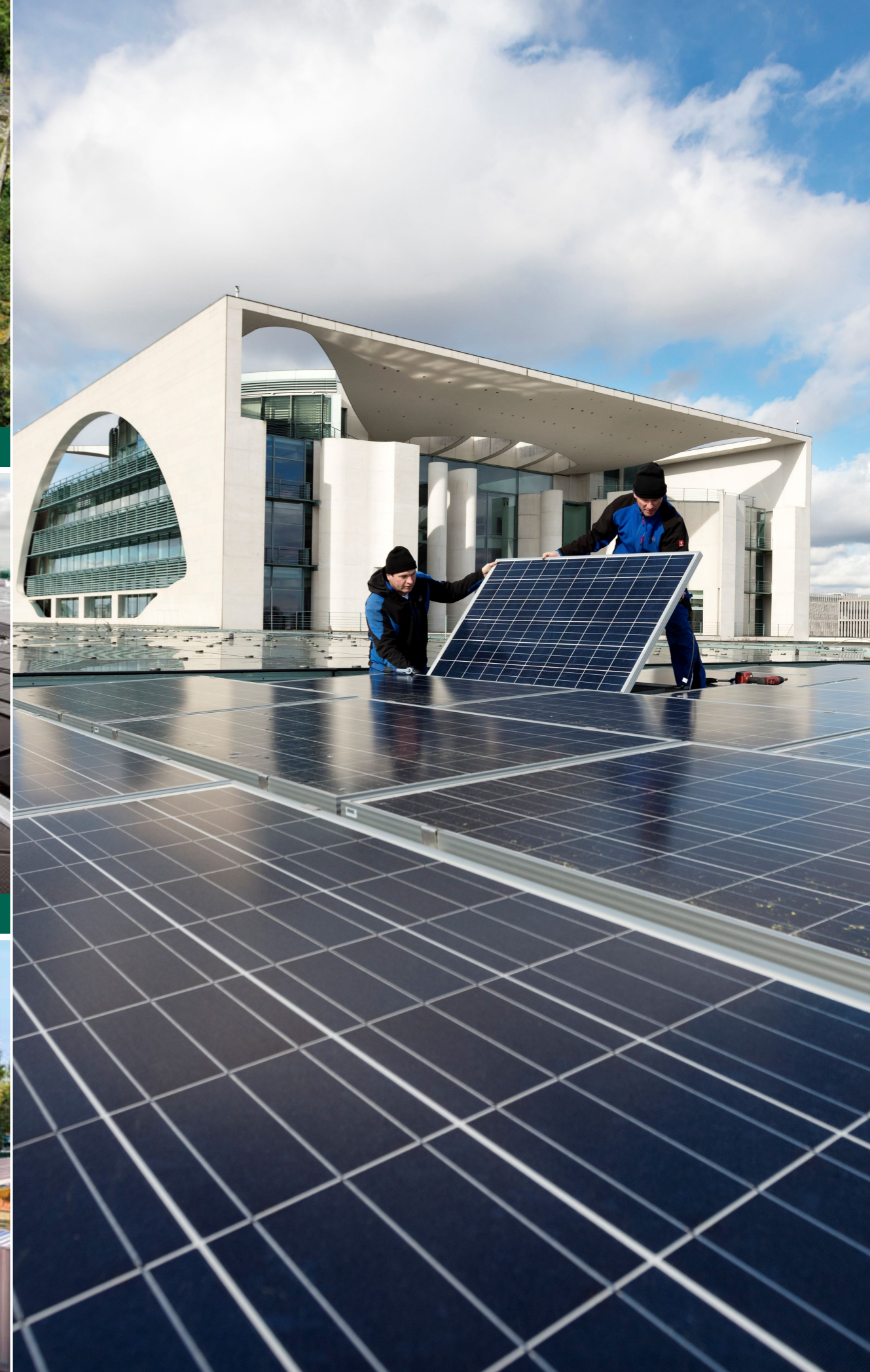
Repowering der PV-Anlage auf dem Bundeskanzleramt in Berlin mit NeMo® Modulen Repowering of the PV system at the Federal Chancellery in Berlin with NeMo® modules
