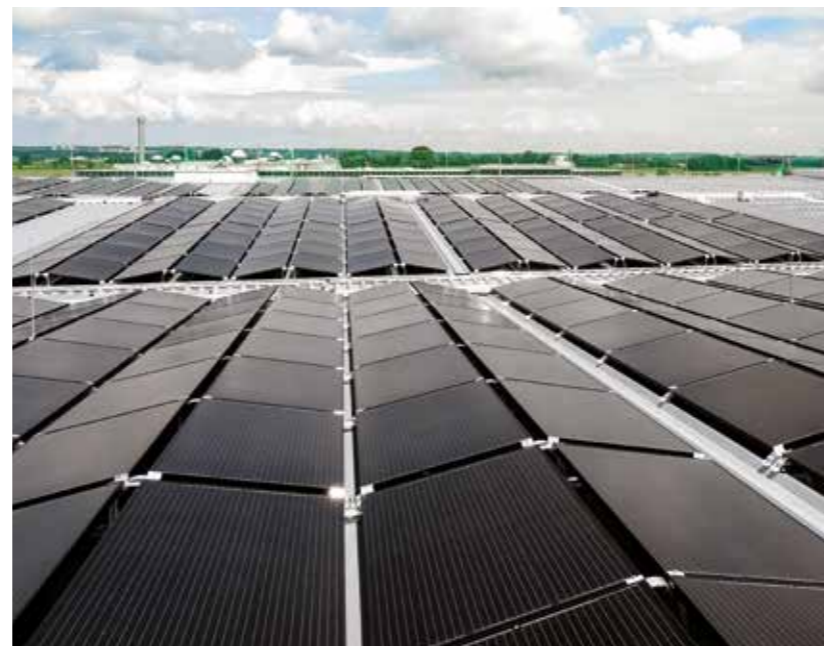
Flughafen München (1,13 MWp) mit besonderem Fokus auf Blendschutz Airport Munich (1,13 MWp) with special focus on glare protection
