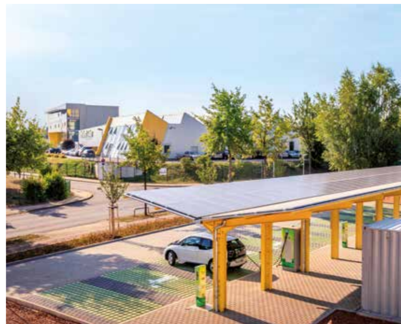
„Grüne Säule“ im Gewerbegebiet an der A72 in Chemnitz „Grüne Säule“ in a business park alongside the A72 in Chemnitz
